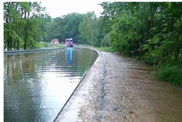
Podtopienie drogi lokalnej
